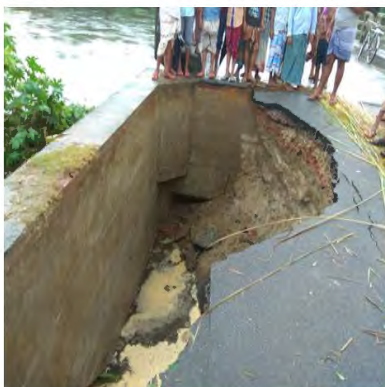
6. m) Collapsed road
